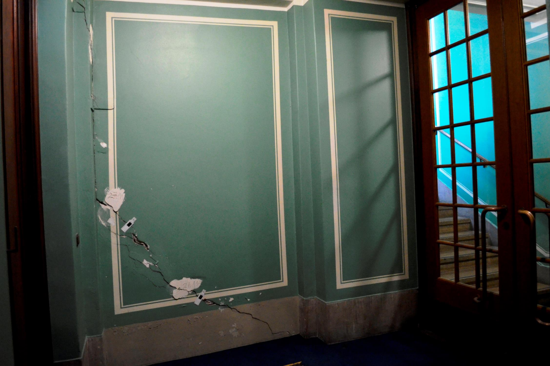
Setzungsriss am Eingang Landtagsseite
