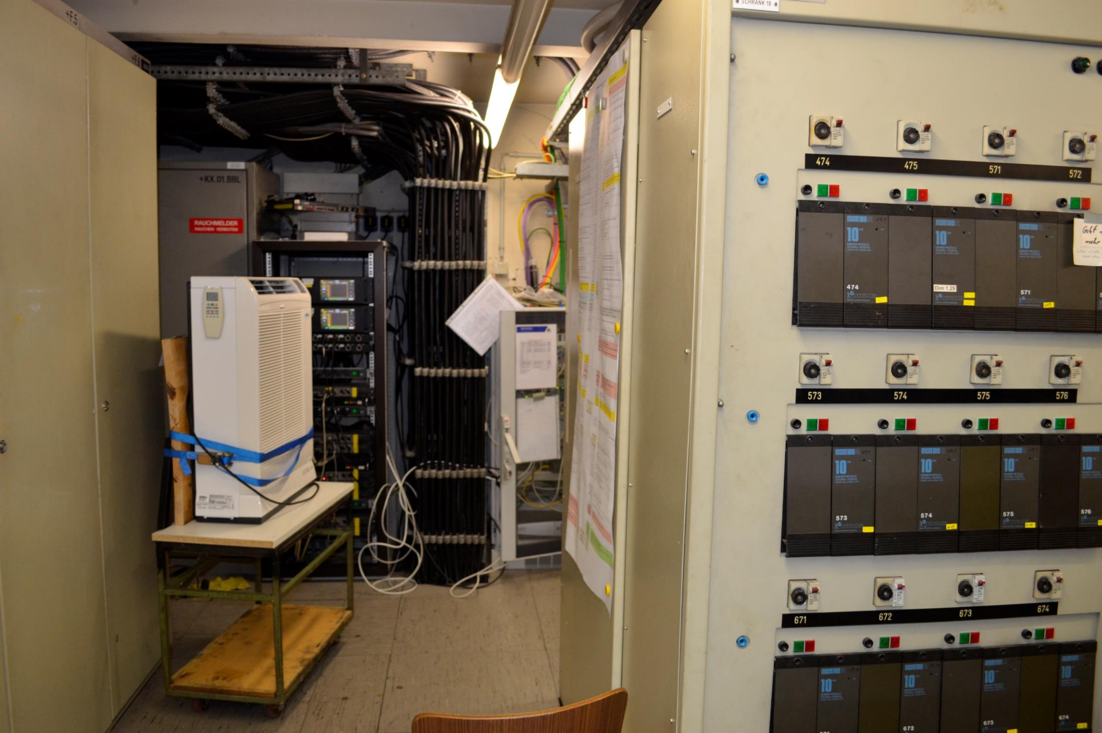
Kühlungs- Provisorium im Dimmerraum
