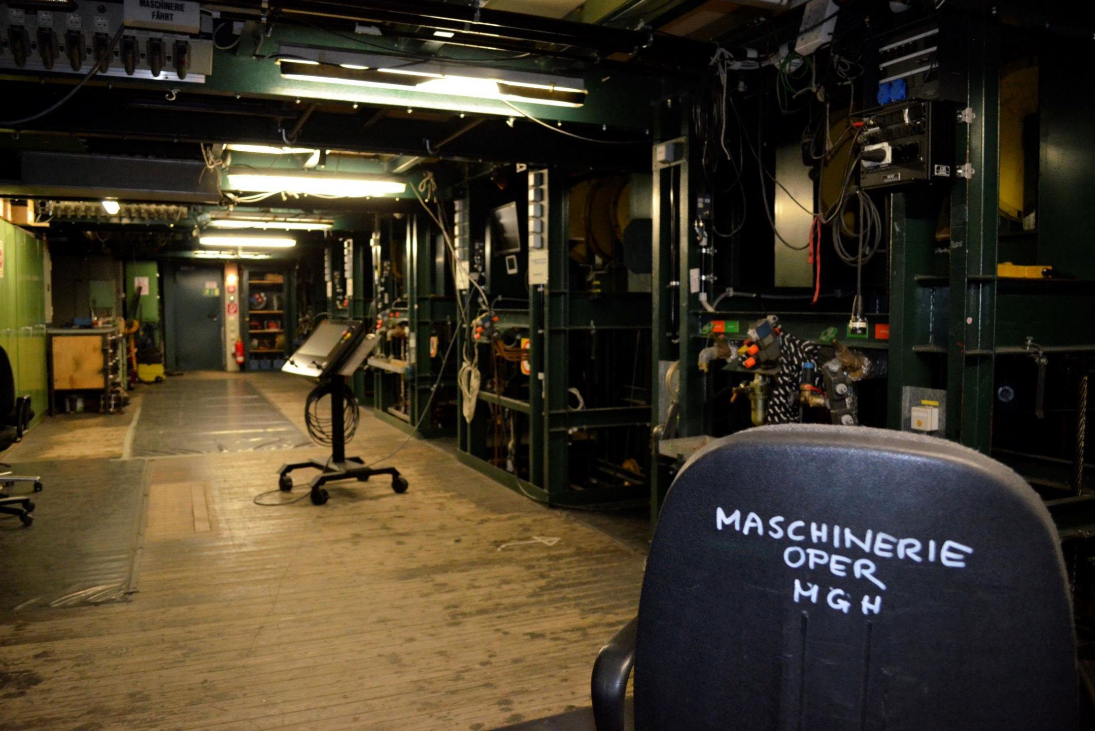
Die Unterbühne: Ein Patchwork veralteter Technik
